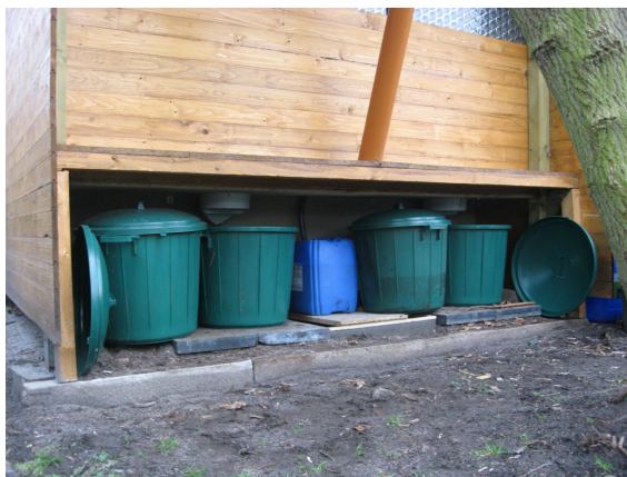
Der Raum unter der Toilette mit den Feststoff-Sammelbehältern und einem Kanister
