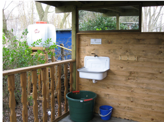
Handwaschbecken mit Wasserhahn im überdachten Vorraum; Wasserkanister außerhalb des Gebäudes
